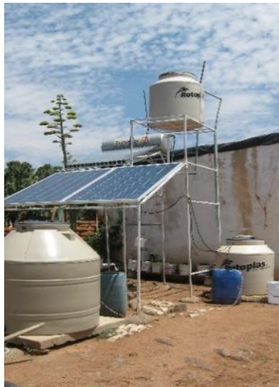
Figura 1. Estructura de soporte, paneles solares, calentador de agua solar y tinacos.
