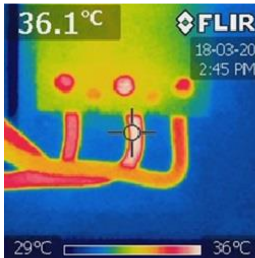
Figura 7. Banco de capacitores 25 y 50 kvar
