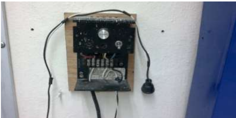
Figura 3.- control manual de la mesa de ensambles.
