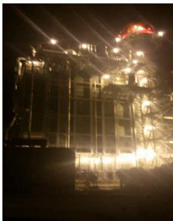
Figura 1. Recuperador de calor de la planta central de ciclo combinado de Poza Rica, Ver.
