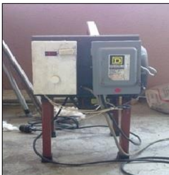
Figura 1. Sistema de control electrónico.
