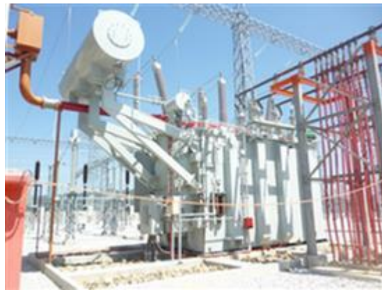
Figura 2. Transformador de potencia.
