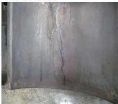
Figura 1.- Se observa la grieta a simple vista en el herramienta.
