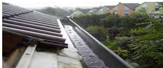
Figura 3. Canaleta en un sistema de captación de agua de lluvias
