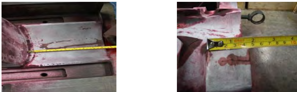
Figura 3.- Se identifica la primera grieta con el revelador c).-.
