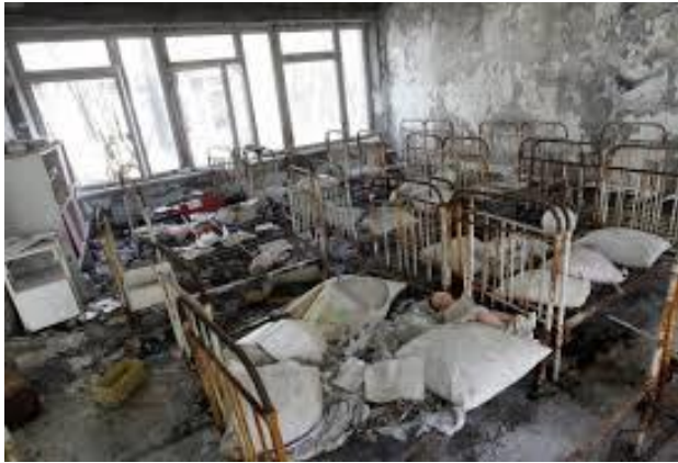
Figura 2. Guardería ABC luego del incendio.
