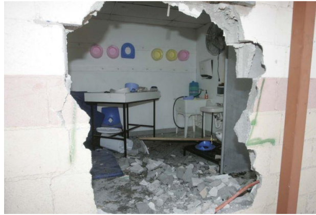
Figura 3. Boquete abierto como “salida de emergencia” en la guardería ABC.
