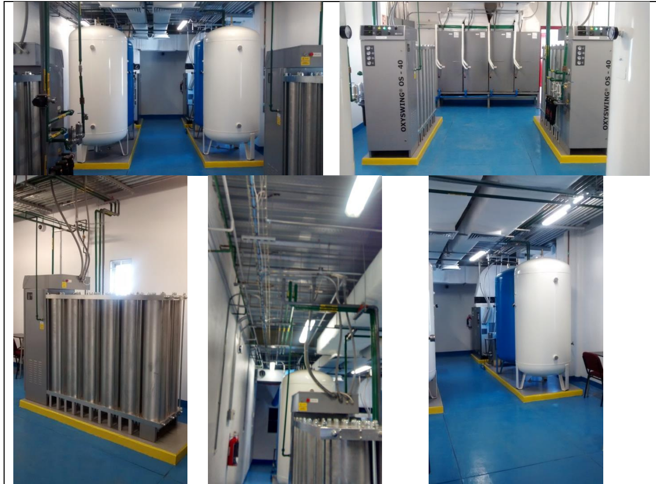
Figura 1. Planta de producción de oxígeno por PSA en el Hospital Civil de Culiacán.
