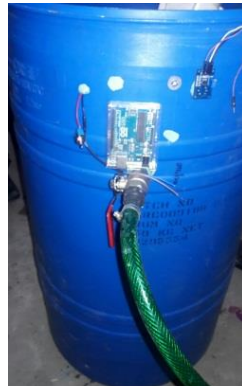
Figura 2. Placa Arduino instalado en el biodigestor
