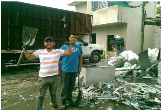
Figura 6. Los trabajadores sin equipo de seguridad
