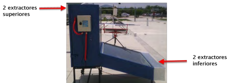
Figura 3. Posición de los Extractores (Inferior y Superior).
