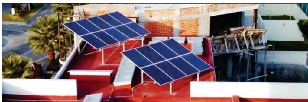
Figura 7. Imagen del sistema fotovoltaico instalado.
