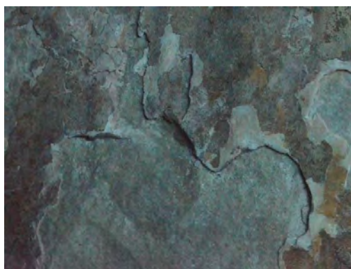
Foto 3. Desprendimiento de pinturas en el Abrigo de la Cañada de Marco, Alcaide, Río Martín, España. Foto Jorge Porras Allende.
