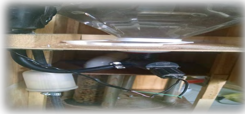
Figura 7 Bomba, solenoide y filtro para agua instalados.
