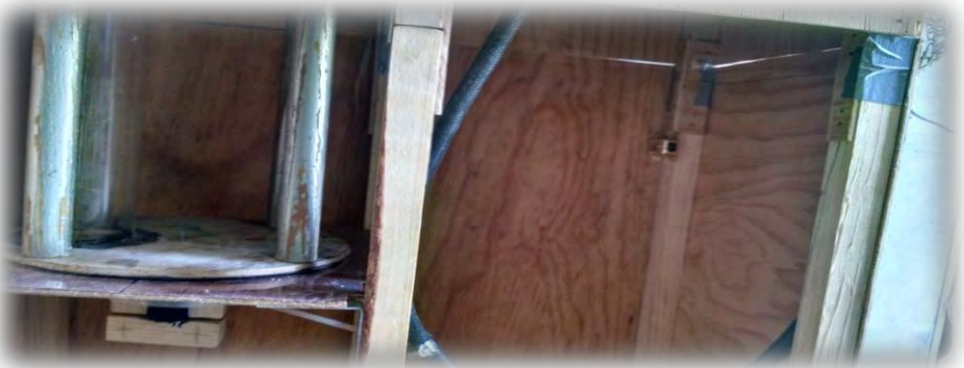
Figura 6 Estructura de sujeción del servomotor con el servo instalado (se observa debajo de la placa inferior).
