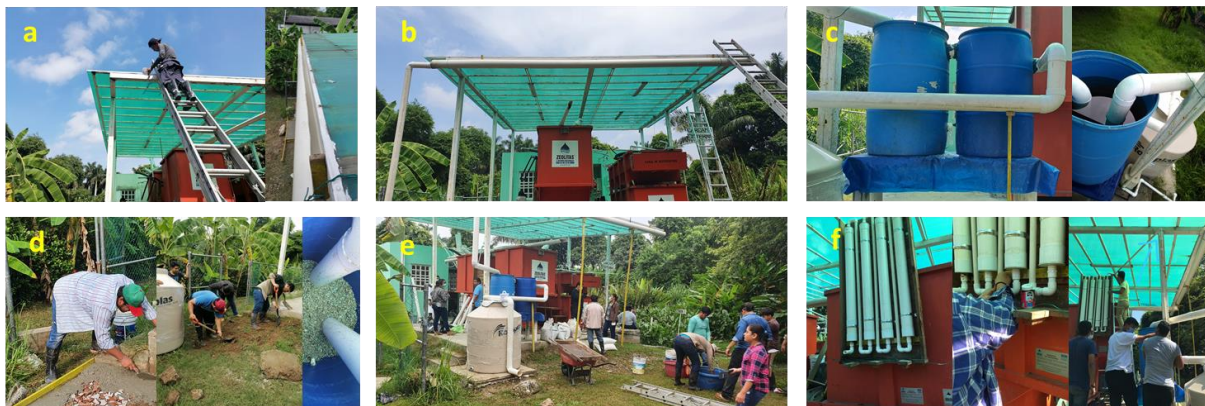
Figura 5. Sistema experimental de captación y tratamiento de agua de lluvia DACBioI-UJAT.
