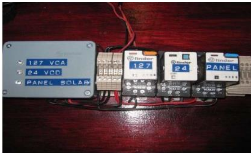
Figura No. 6 Montaje en riel DIN del circuito electrónico y de control diseñados
