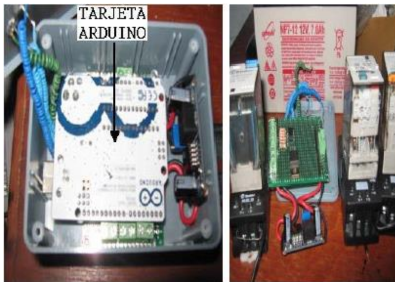
Figura No. 5 Montaje de la tarjeta Arduino y el sistema de control
