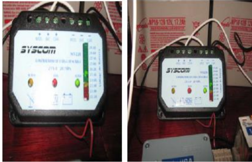
Figura No. 7 Conexión del controlador de carga de baterías .y conexión.
