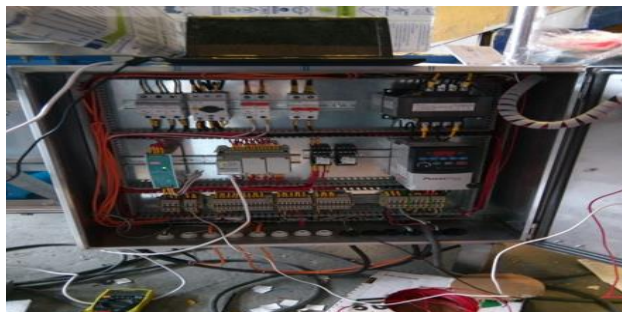
Figura 8. Gabinete con cableado Fuente: Elaboración propia
