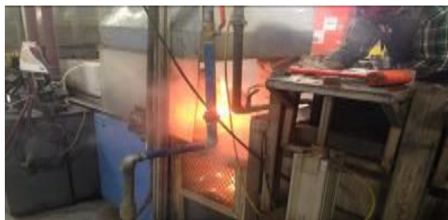
Ilustración 2 Conato de Incendio
