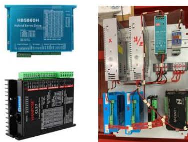
Figura 5. Drivers para motores NEMA 34 y 23 montados en máquina de corte
