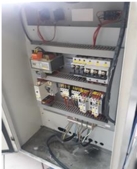
Imagen 3.- verificación de los tableros de control de las máquinas.
