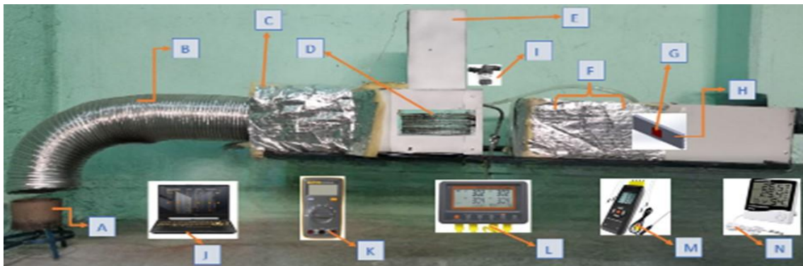
Figura 1. Cosechador de energía residual para la generación de diferencia de potencial vía TEM. Equipo real. Partes del cosechador A. Quemador B. Ducto de gases de combustión. C. aislante térmico. D. Recuperador de calor de tubo aleteado E. Sistema chimenea F. Batería térmica G. Módulo TEG H. Disipador de calor de aletas rectangulares. I. Bomba de agua.
