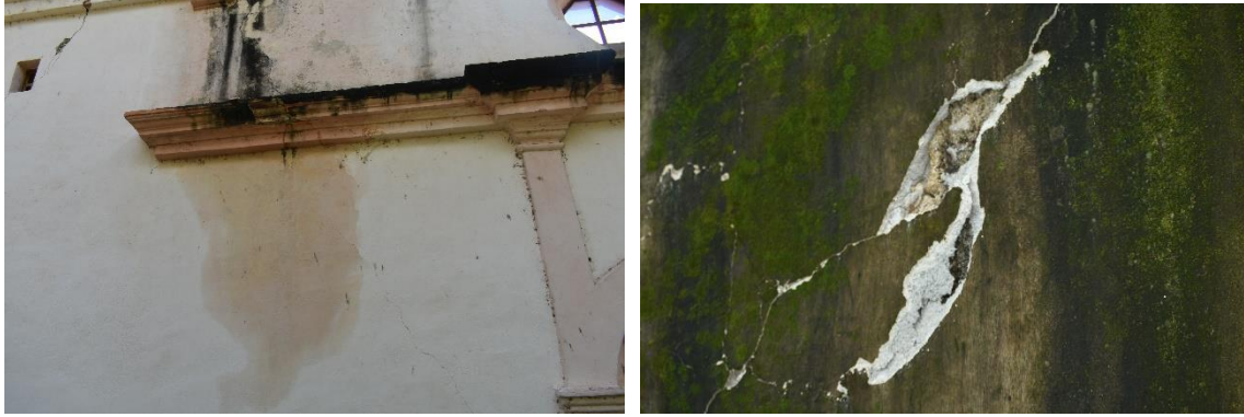
Fotos 9 y 10. Evidencia del abandono del inmueble. Fuente: David Nava Díaz
