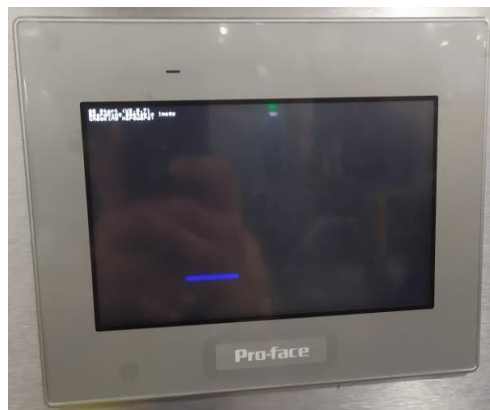
Figura 3. Panel de control de la celda
