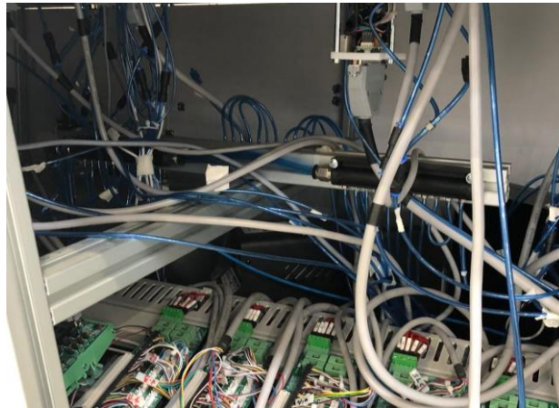
Figura 5. Cableado de sistema eléctrico y neumático.
