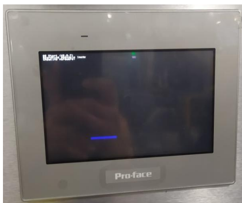
Figura 3. Panel de control de la celda
