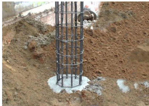
Figura 5. _ Pilote colado en el sitio, con diámetro de 30 cm, 20 m de longitud y f'c de 250 kg/cm 2
