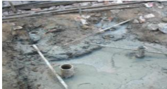
Figura 6. _ Pilotes con cimbra de tubo PVC rígido, 15 cm de diámetro 6 m de largo
