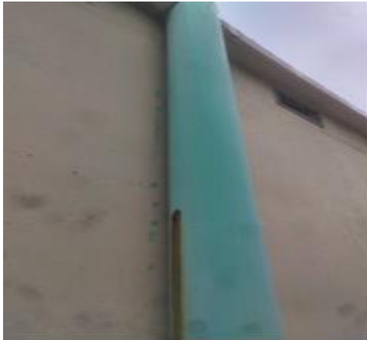
Figura 5: Oxidación de tubería.
