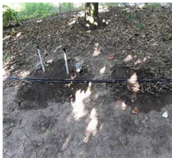
Figura 2. Instalación del sensor Watermark® y zona de bulbo de mojado del emisor de un gasto de 2.0 l h -1 , en un cultivar de naranja Valencia.
