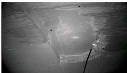
Figura 10. Cara interna de una bóveda tradicional con una reparación de sobrebóveda monolítica.
