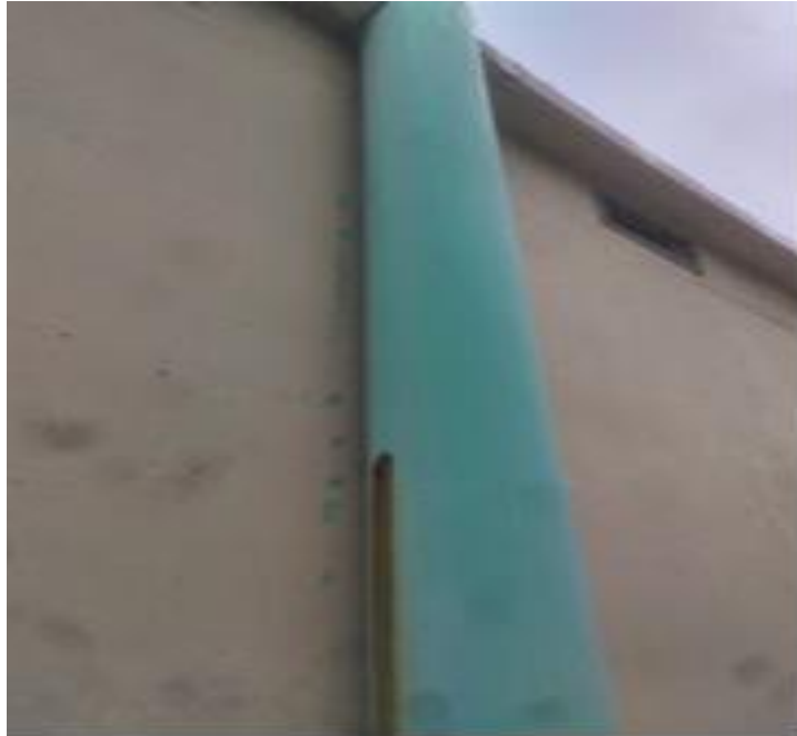
Figura 5: Oxidación de tubería.
