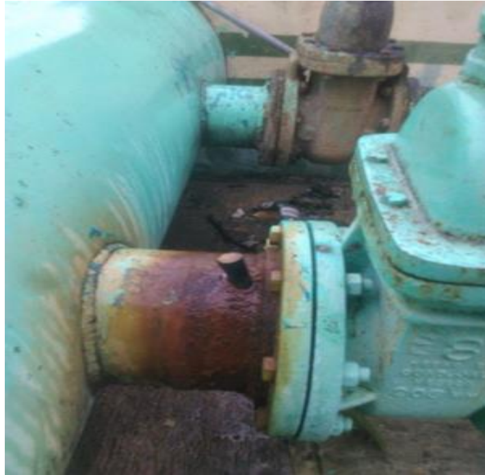
Figura 3: Tubería dañada por corrosión.
